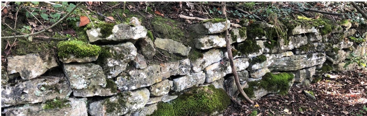
Abb. 17: Beschädigte und überwachsene Trockenmauer
